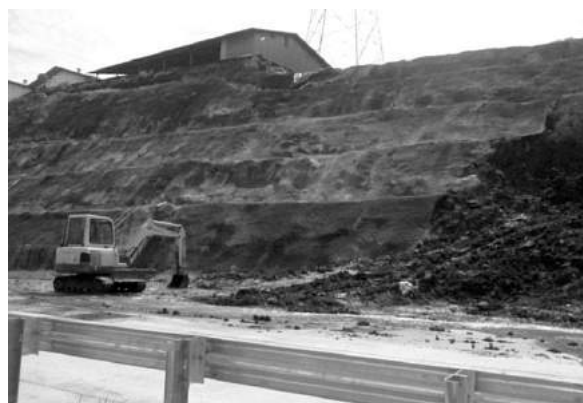
Gambar 5. Kondisi Lereng Lokasi Longsor
