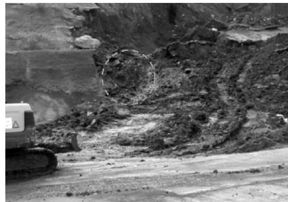
Gambar 7. Rembesan Pada Lokasi Longsor
